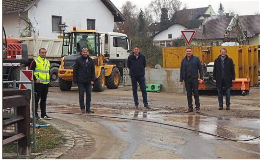
Am „Stachus“ soll bis Dienstag asphaltiert sein, die Fertigstellung des Teilstückes in der Brückenstraße ist bis Mitte Dezember vorgesehen.
